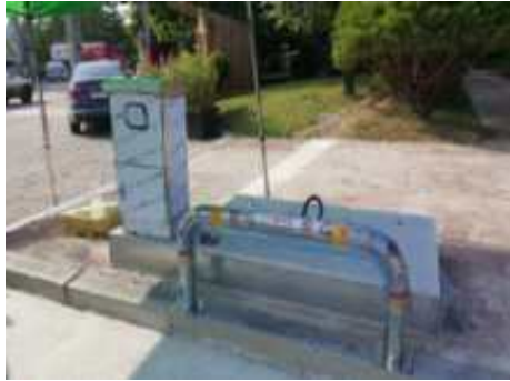
<충전시설 설치전 전경(실외)>
