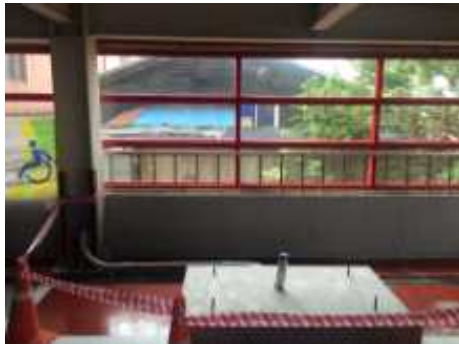
<충전시설 설치전 전경(실내)>
